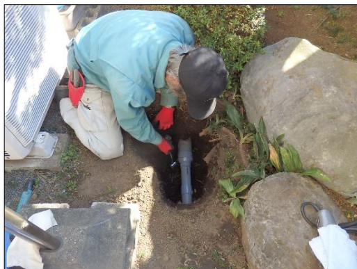
梶田町 Y 邸の排水管詰まり修理
