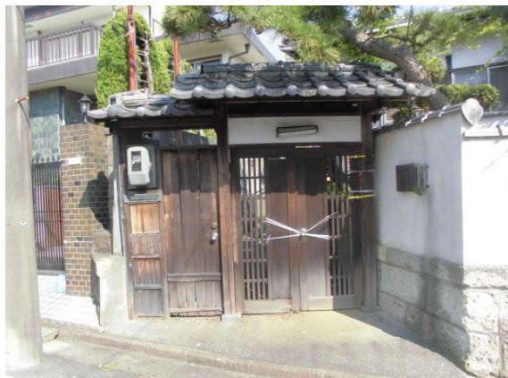
柱がシロアリ被害で倒壊しそうな門扉
